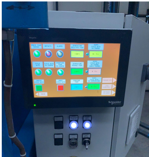
Stazione di comando
